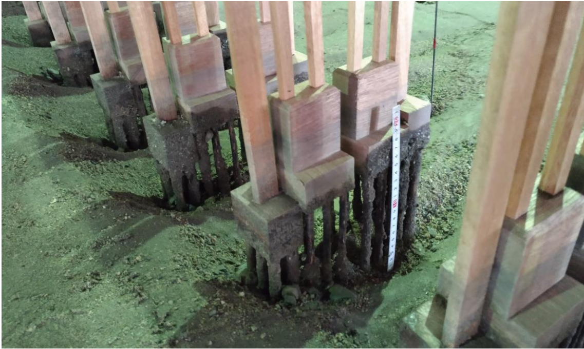
圖 9.5 50 年重現期最大沖刷橋墩沖刷深度
