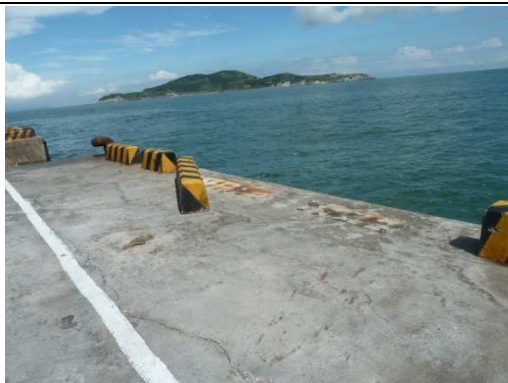
南防波堤兼碼頭北側車擋劣化情形 1
