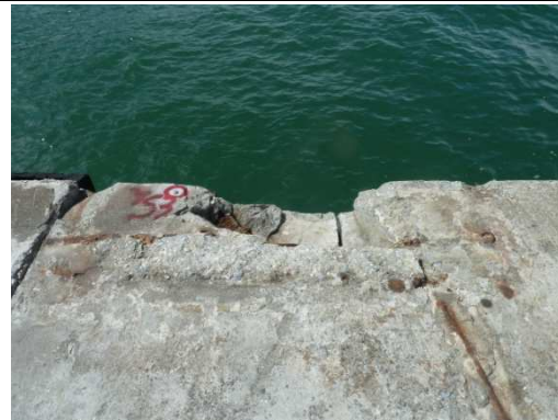
南防波堤兼碼頭南側車擋劣化情形 2
