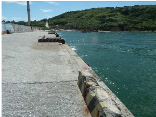
南防波堤兼碼頭南側車擋劣化情形 1
