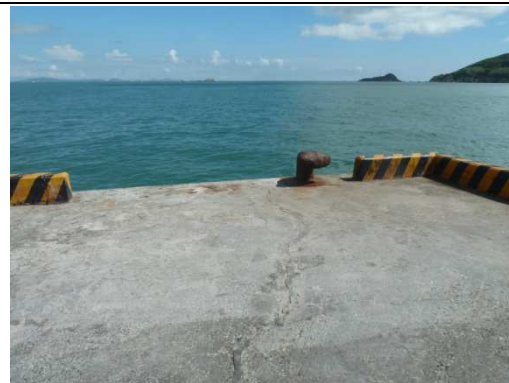
南防波堤兼碼頭北側車擋劣化情形 2
