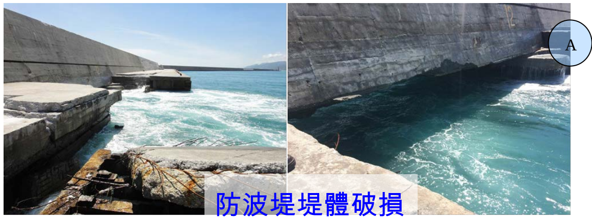
圖 9.17 花蓮港東防波堤破壞情況(1)
