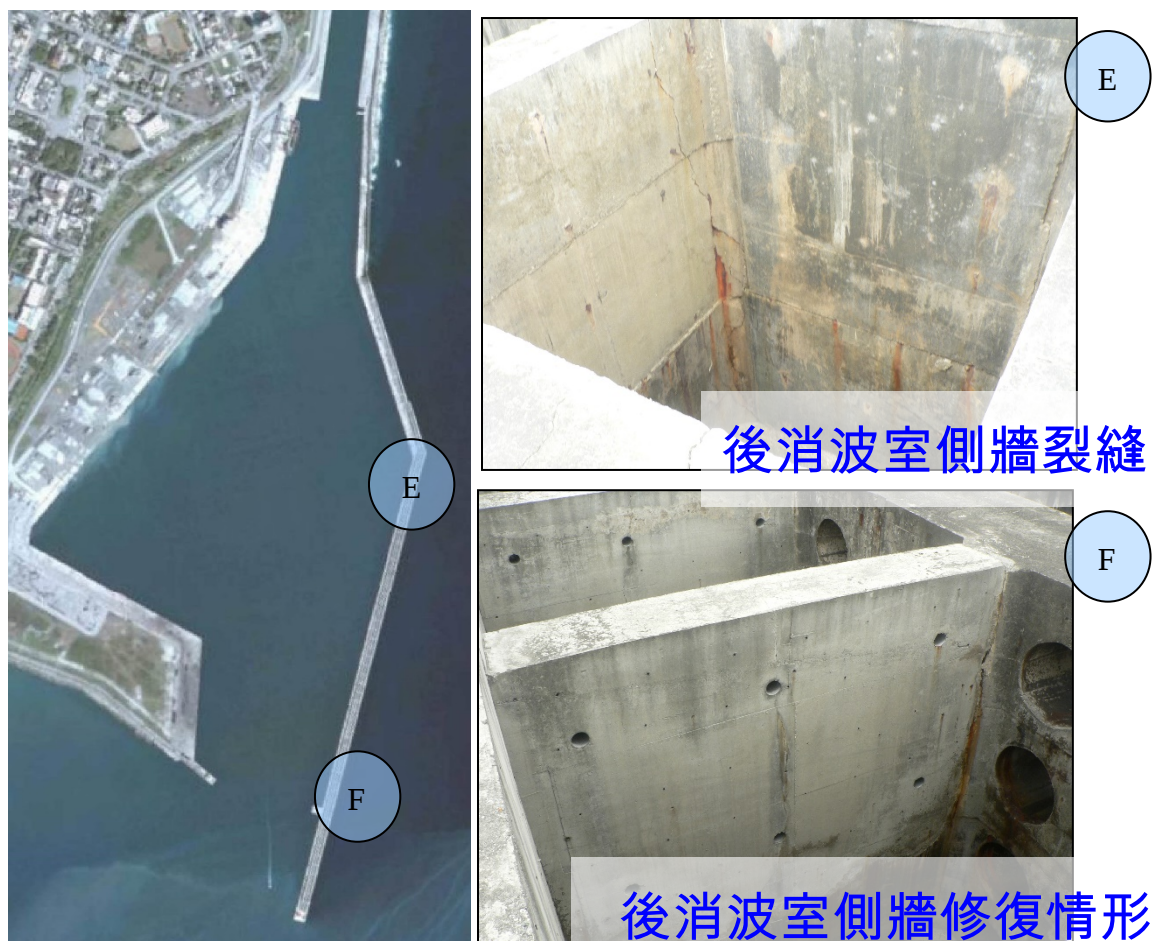
圖 9.19 花蓮港東防波堤破壞情況(3)
