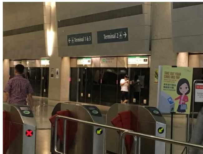
圖 51 捷運樟宜機場站閘門
