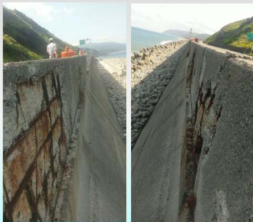
南興段(440K+900)水泥護欄受波浪衝擊剝落情形 左圖為向北拍攝，右圖為向南拍攝
