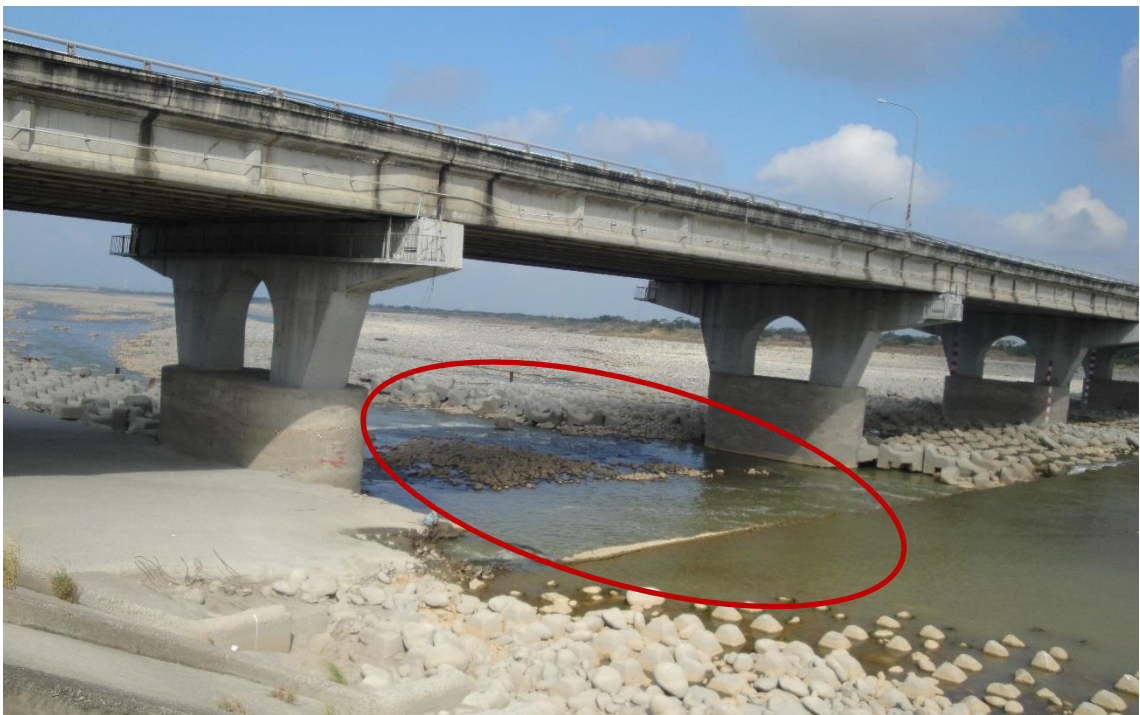
圖 5.4 大甲溪橋鼎形塊冲刷流失狀況
