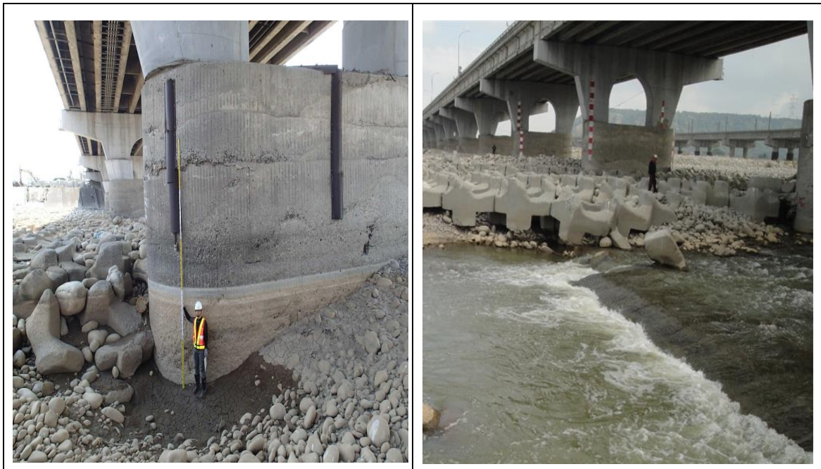
圖 6.1 大甲溪橋墩基礎沖刷與鼎形塊流失狀況
