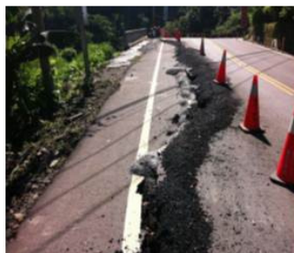
里程52K+80~+160 道路開裂(青山工程顧問公司)
