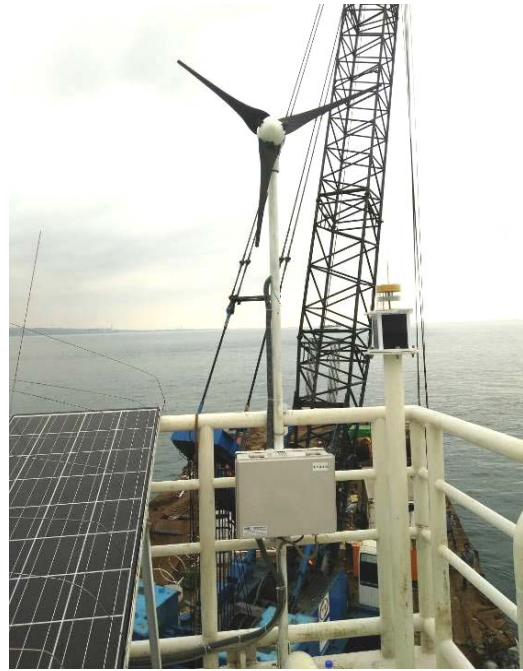
圖 6 葉片式風力發電機
