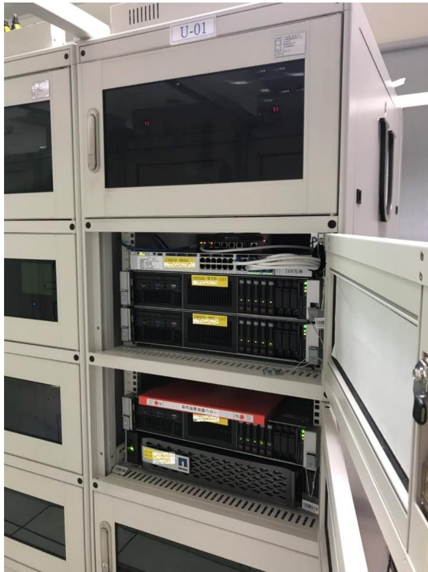
圖 3-242 臺灣環境資訊系統(臺中文心 IDC 租用機房)
