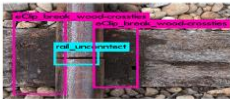
軌道未鏈結與扣件遺失
