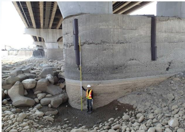
臺1線P27沉箱基礎裸露約6.3公尺 4
