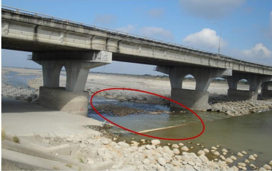
臺1線大甲溪橋鼎形塊沖刷流失狀況 3
