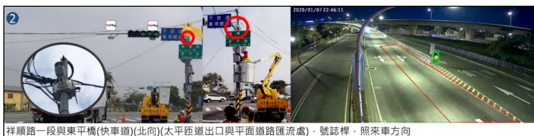
圖 4.2.7 太平匝道出口與平面道路匯流處(藍 2)偵測設備架設位置與畫面
