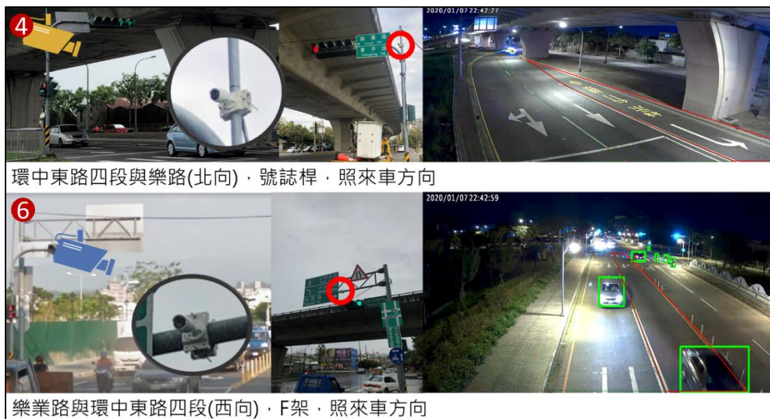
圖 4.2.5 環中東路四段與東平橋路口(紅 4、6)偵測設備架設位置與畫面
