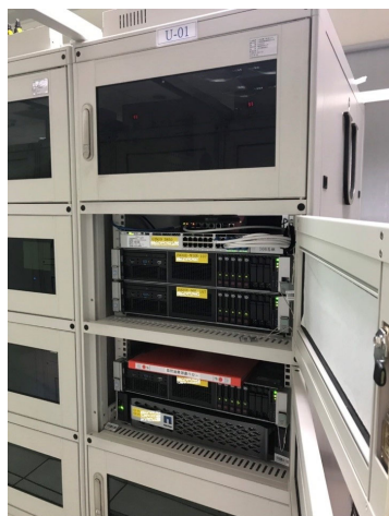
配合用電檢查進行 HA 切換測試
