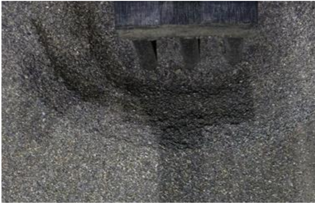
圖 5.5 無保護工基礎冲刷情形
