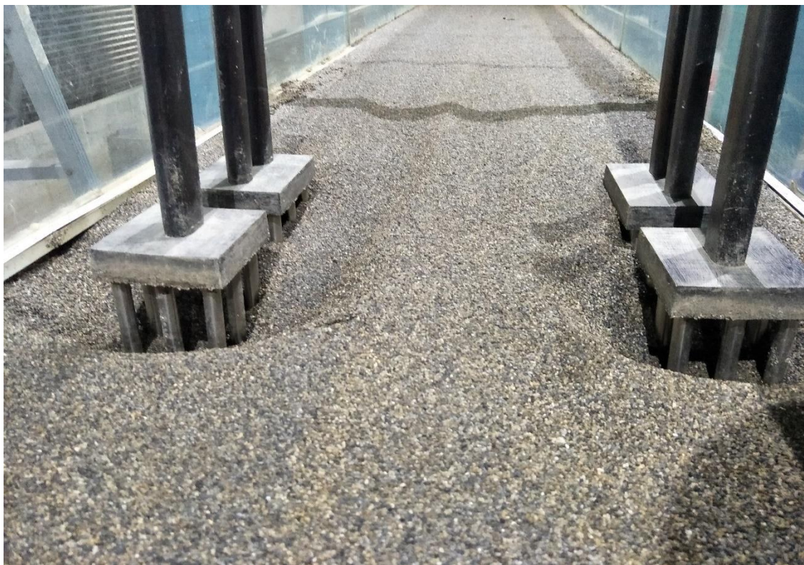
圖 2.16 無保護措施基礎沖刷情形
