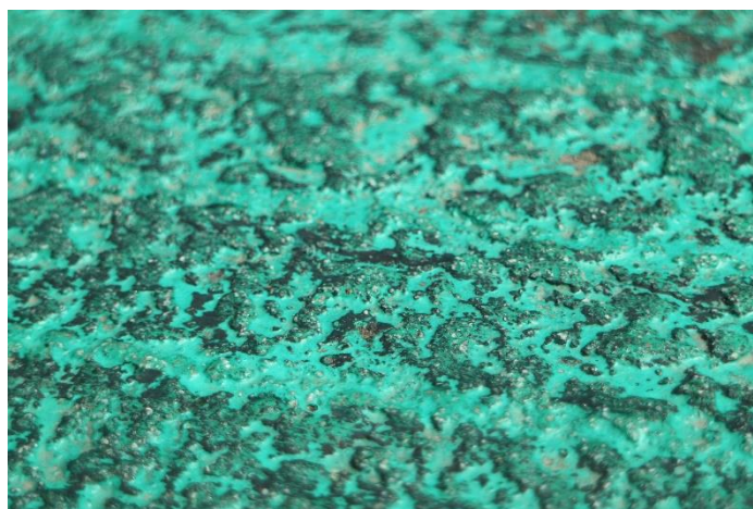
圖 50 因過早通車而造成標線表面汙染之冷塑標線
