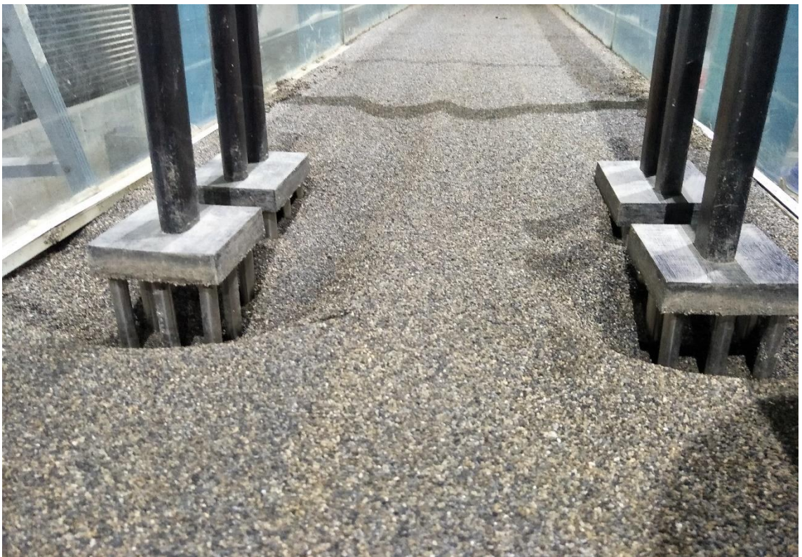
圖 2.18 無保護措施基礎沖刷情形
