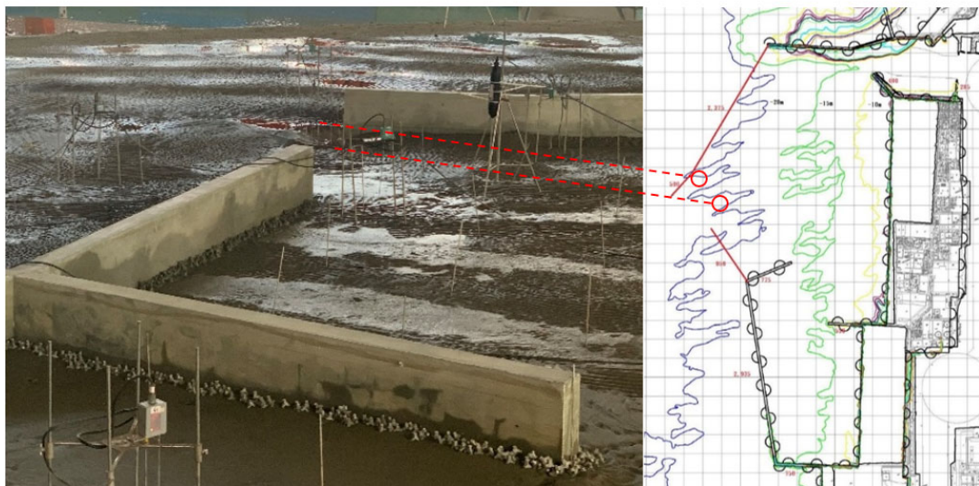
10.外廓堤延伸模型試驗第2年後，防波堤內外側附近產生掏刷現象
