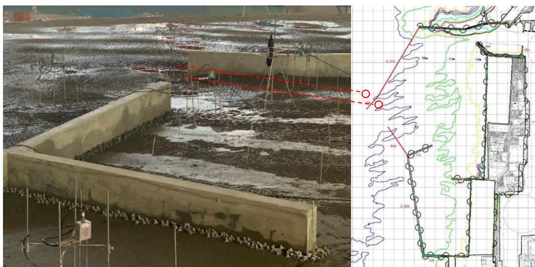
圖 3.10 北外廓防波堤南北側掏刷現象
