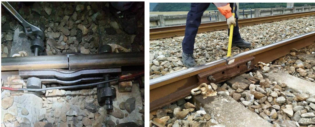
圖 1.2 鋼軌因寒冷導致焊點拉裂 [6]
