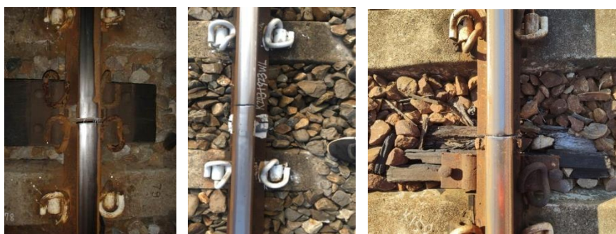
圖 4.13 軌面缺失 (XX) —鋼軌裂縫
