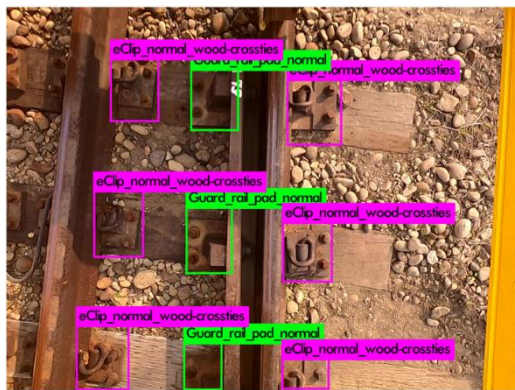
(a) 軌道構件影像自動辨識
